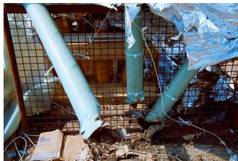
Folgen eines Rohrkrepiers
